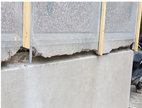
Afskallet, afbrækket beton
