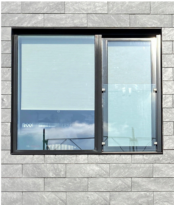
Her vises et eksempel på en tilsvarende facade som den foreståede. Dette er fra byggeriet Spindekrogen i Herlev.
