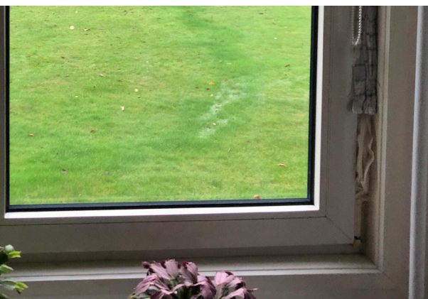
Utæt vindueselement, hvor det trækker voldsomt ind. Restlevetiden er begrænset. Vinduer er udgået af produktion og det er ikke muligt at få reservedele.
