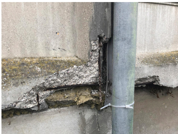
Afskalninger i betonkant ved sokkel
